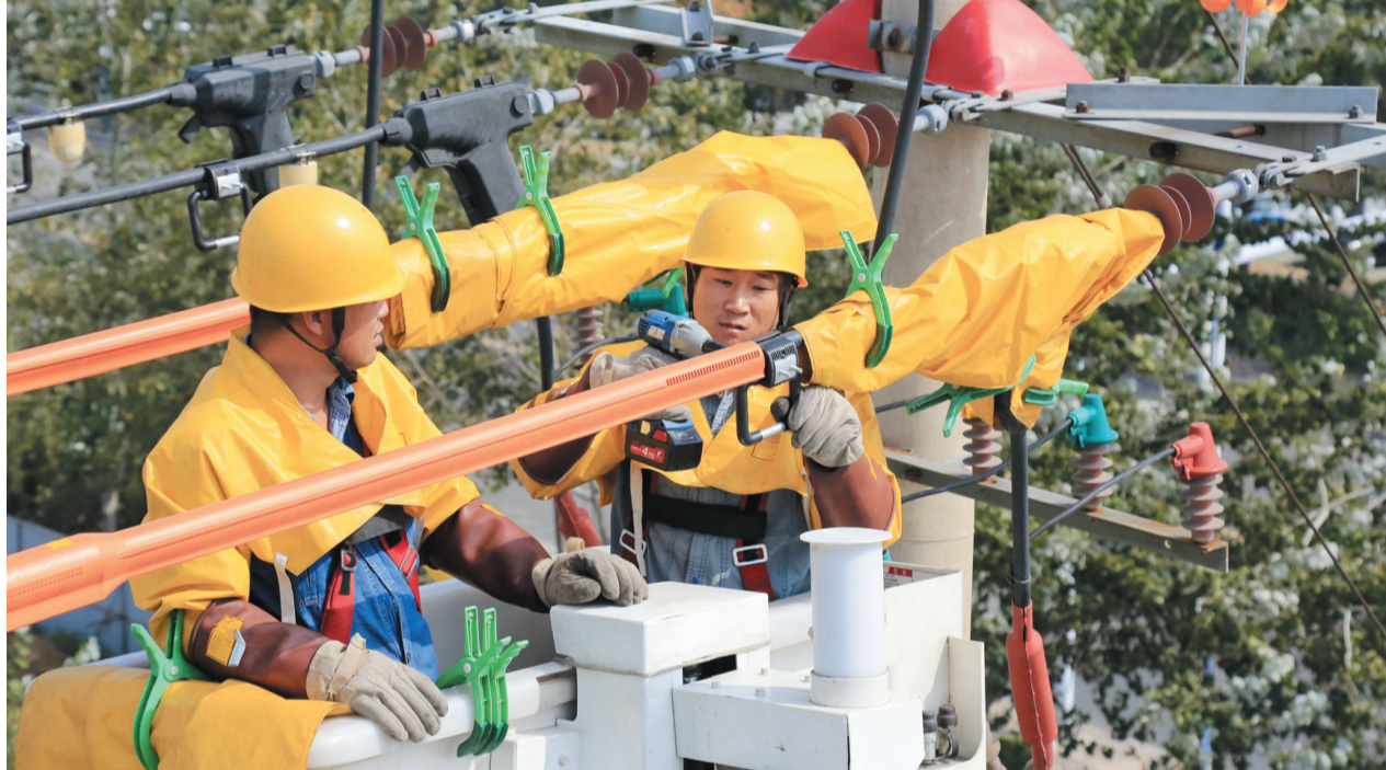
国网滨州供电公司带电作业车的绝缘升降斗,平稳地靠近正在运行的10千伏长三甲乙线41号杆线路。之后,站在升降斗内的两名工人开始进行10千伏配网带电作业。
