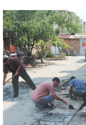
年久失修的老旧小区路面坑洼不平,雨季积水严重。
