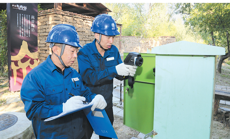
国网滨州供电公司员工在西纸坊·黄河古村风景区利用红外测温仪为景区配电箱内易发热设备测温。
