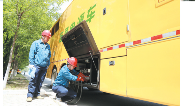
国网滨州供电公司员工在高考考点北镇中学调试应急发电车。
