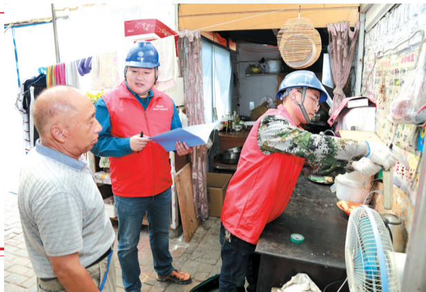
国网滨州供电公司彩虹共产党员服务队队员在机电小区客户贺德龙家中,为其检查家中线路,排除用电隐患。
