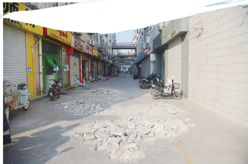
整修前破损的路面。
