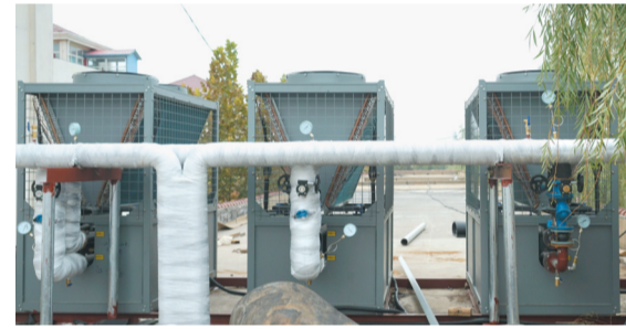
刚刚建成的空气源热泵主机。
