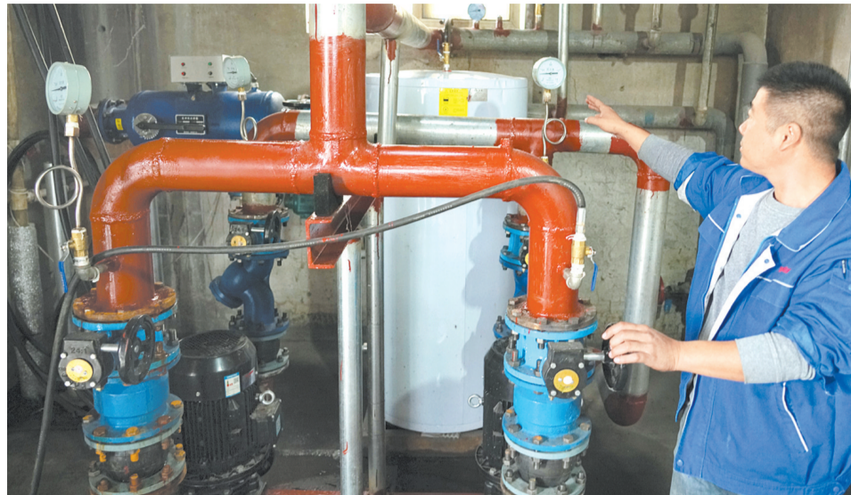
超越地源热泵公司在宝山混凝土公司建成的空气源热泵机房。
