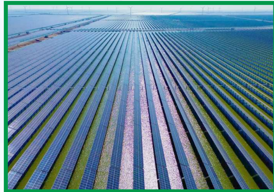
宏辉新能源渔光互补发电项目。
